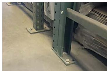
Entorno con un nivel bajo de corrosión típico: depósito interior
