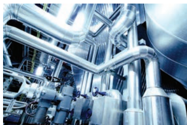
Entorno altamente corrosivo típico: planta central de servicios públicos
