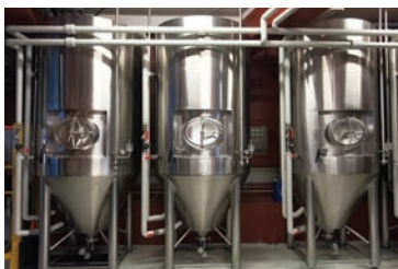
Entorno altamente corrosivo típico: planta procesadora de alimentos
